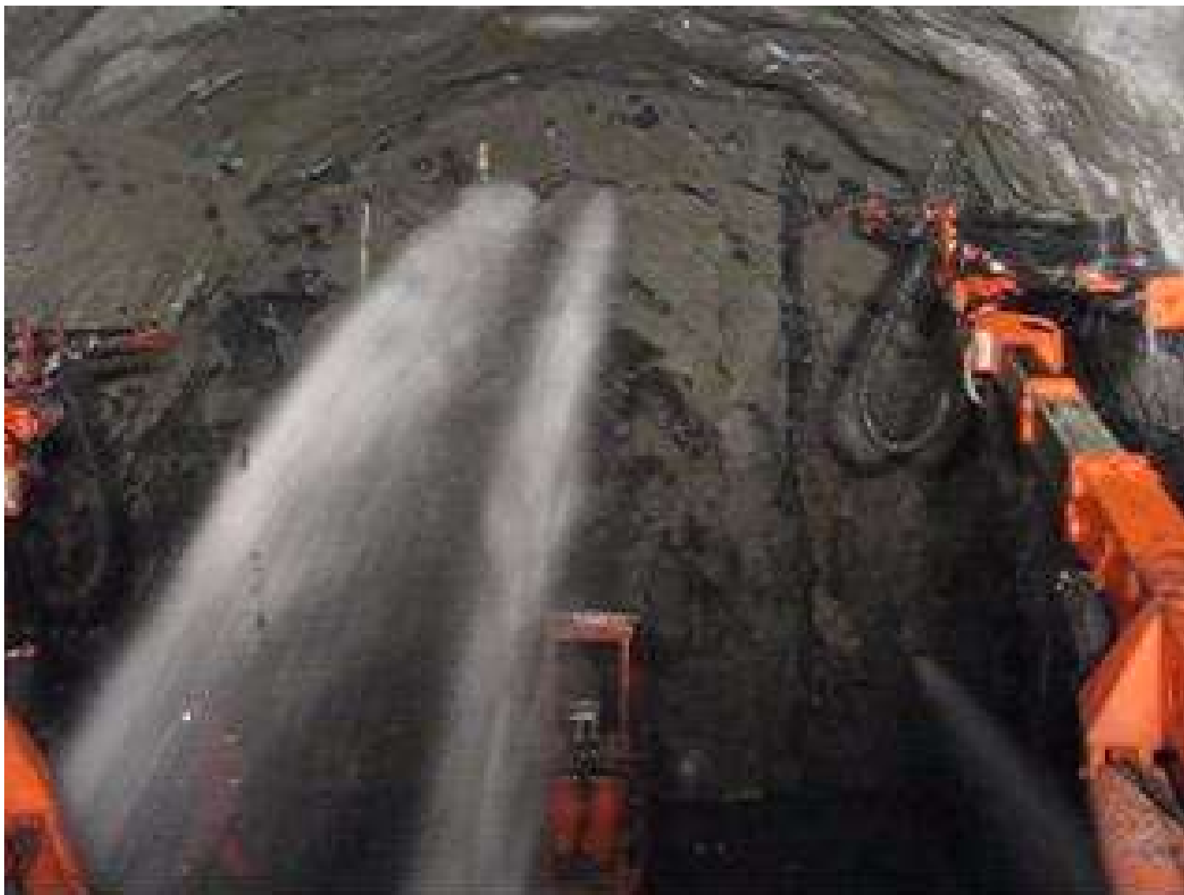
Tunel Siglufjordur – výrony tlakové vody do čelby tunelu
