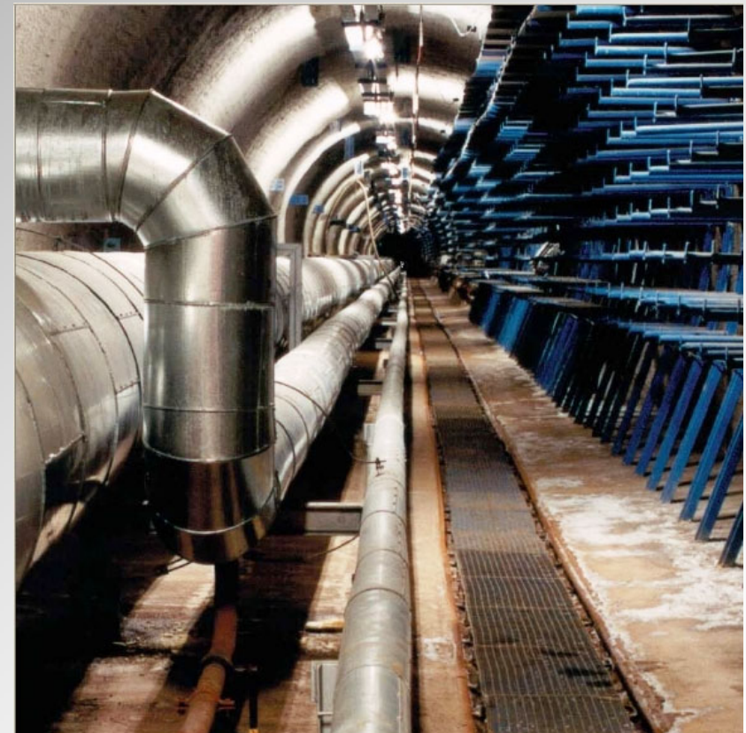
Kolektor Orlí (Brno)
