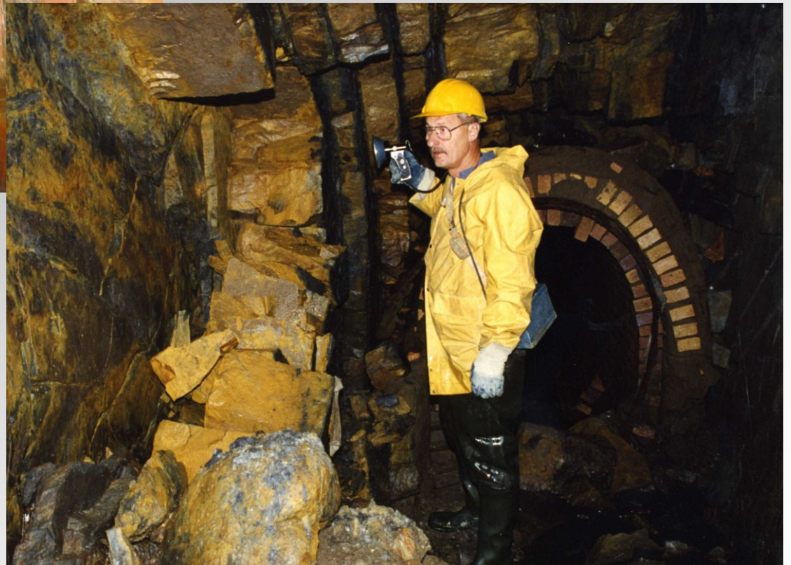
Havarovaná stoka Trojská (Praha 8)
