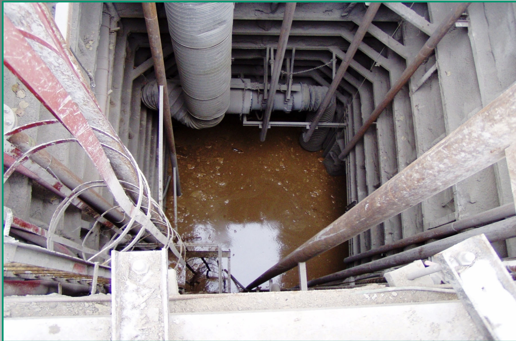
Šachta kolektoru Vodičkova (havária 2005)
